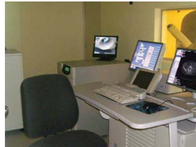
Cuarto de Control
